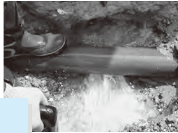
漏水した水道管
