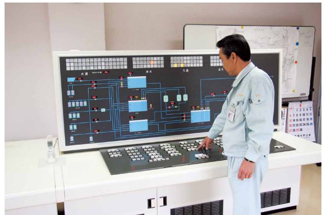
浄水場中央監視装置
