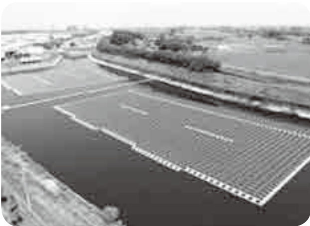
太陽光発電設備の設置例
