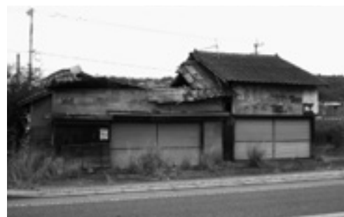
危険家屋(撤去済み)
